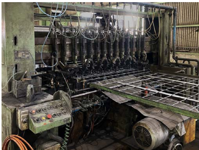
▲オーバーホール前の溶接機 汚れはもちろん、消耗摩耗部品が多く、調整が非常に困難な状況
